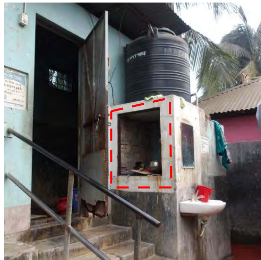
トイレ内へ給水のために設置したポンプがない [2023 年 6 月]
